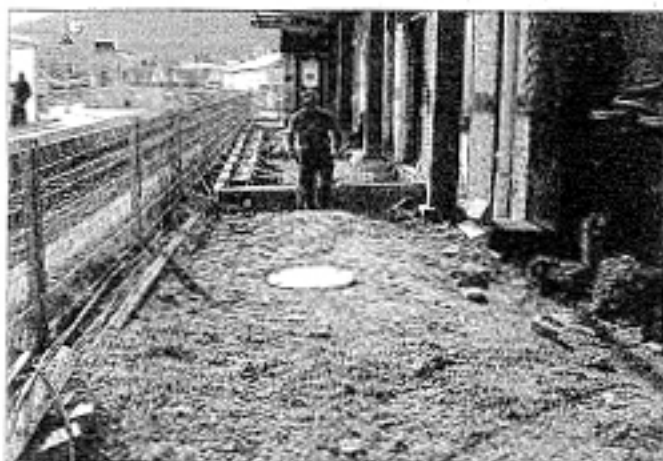
Schwer gearbeitet wird derzeit am Oberkochener Bahnhof, ab Ende April wird er eingerüstet. (Foto: ls)
